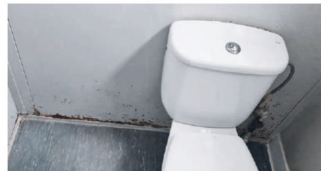
Detalls de l'estat dels barracons on està l'escola. CEDIDES
