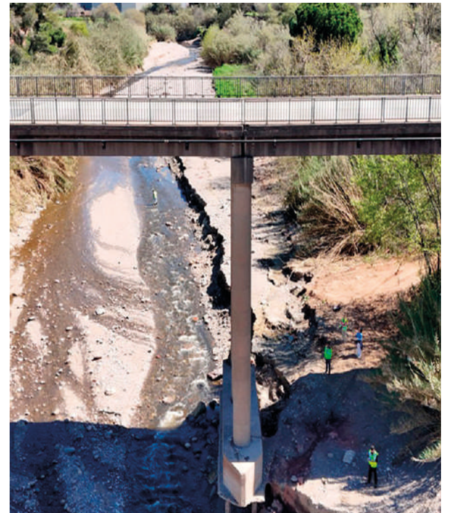
El pont va quedar malmès a causa dels forts aiguats de mitjans de març. AJUNTAMENT DE RUBÍ
